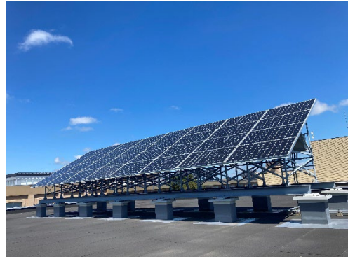
(文京町) 大学会館 太陽光発電設備
