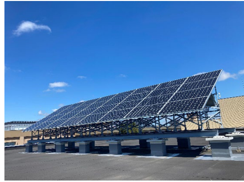
(文京町) 大学会館 太陽光発電設備
