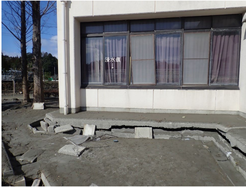
写真6 (図2-P6) 建物壁面に見られる浸水痕.
