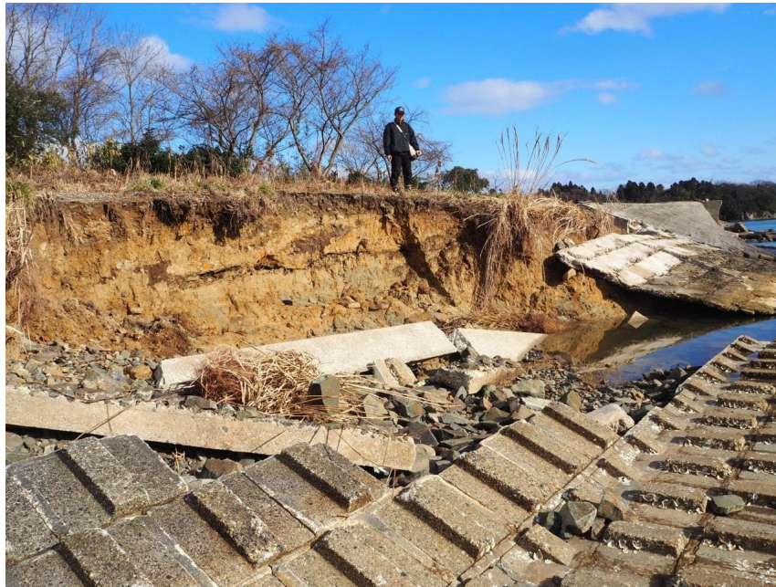
写真1 (図2-P1) 九里川尻川の河口左岸付近では幅5m程度の破損箇所が見られた。
